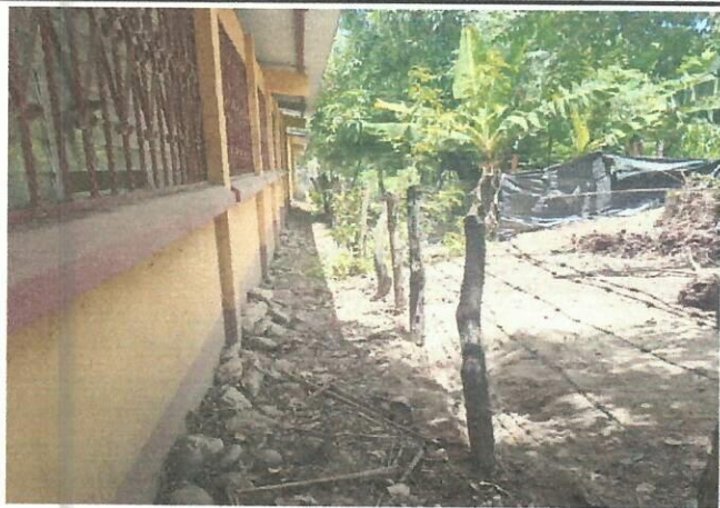
Foto 1: SE REALIZARÁ MEJORAMIENTO DE MURO PERITRAL, DEBIDO A QUE SE ENCUENTRA CON CERCO DE ALAMBRE.
