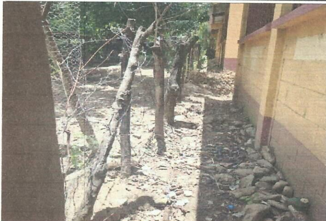
Foto 2: SE REALIZARÁ MEJORAMIENTO DE MURO PERITRAL, DEBIDO A QUE SE ENCUENTRA CON CERCO DE ALAMBRE.
